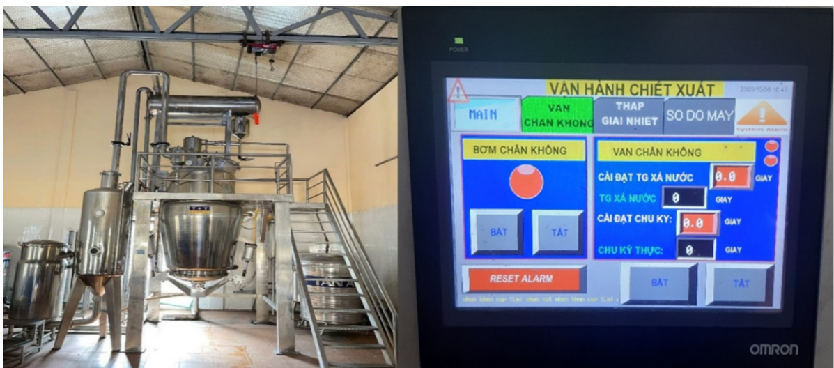
Hệ thống chiết xuất - cô đặc tuần hoàn chân không
